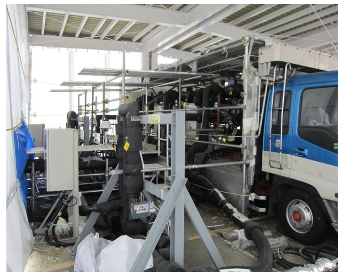
< 常用高台炉注水ポンプ >
