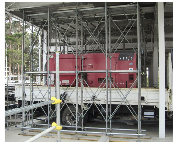
< 非常用ディーゼル発電機 >
