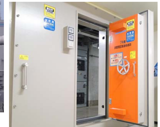
水密扉: 重要機器室への浸水を防止(約60箇所)
