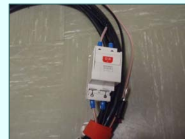
仮設操作スイッチ と仮設ケーブル
