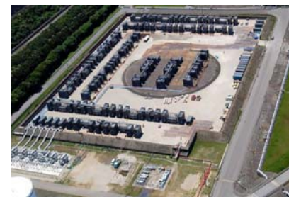
袖ヶ浦火力発電所 (GE102台)
