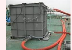
海水循環型浄化装置
