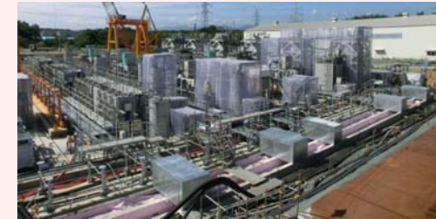
ALPS設置エリアの全景
