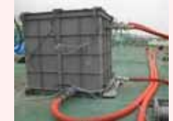
海水循環型浄化装置
