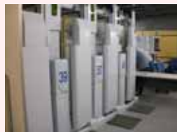
ゲートモニタ設置状況
