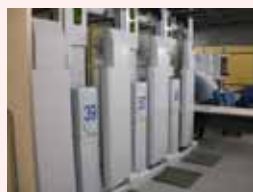
ゲートモニタ設置状況
