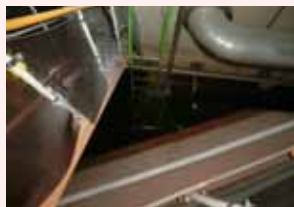
3号機トラス室(北西入口)
