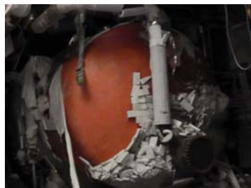
1号機 非常用復水器(B)
