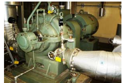
3号機 タービン補機冷却系ポンプ
