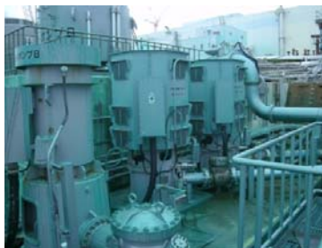
1号機 屋外海水設備 (主要海水ポンプ)
