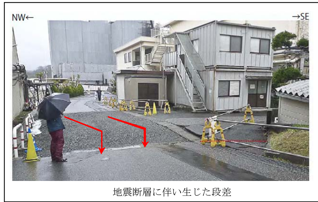
図4 湯ノ岳断層沿いに出現した地震断層
