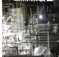
III. 除染装置
