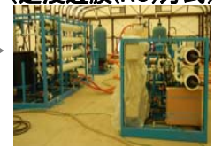
IV. 淡水化装置 (逆浸透膜(RO)方式)
