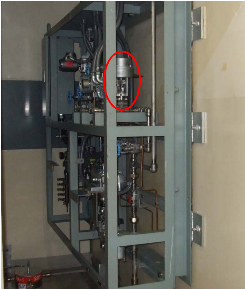
試料採取用のラックに設置された弁 (24機器)
