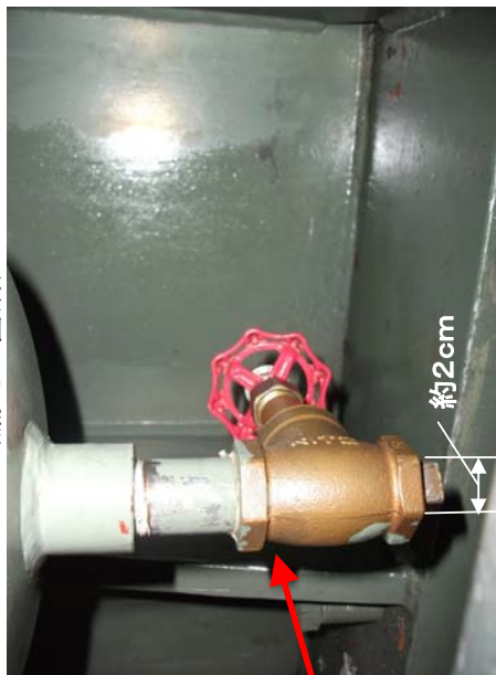
閉止栓 (漏えい箇所)
