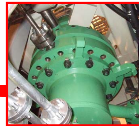
インターナルポンプ電動機(10台)
