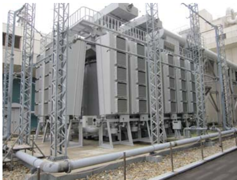
主変圧器の外観
