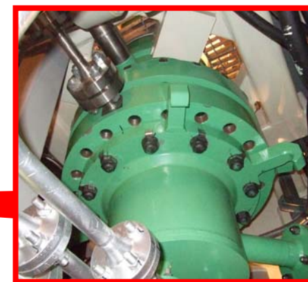
インターナルポンプ 電動機(10台)
