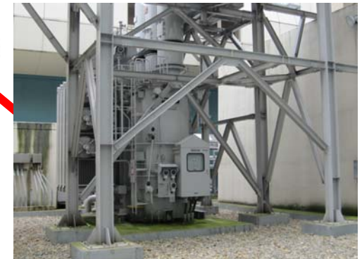
所内変圧器の外観
