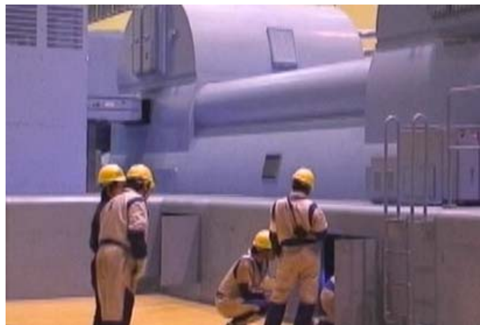
発電機の確認
