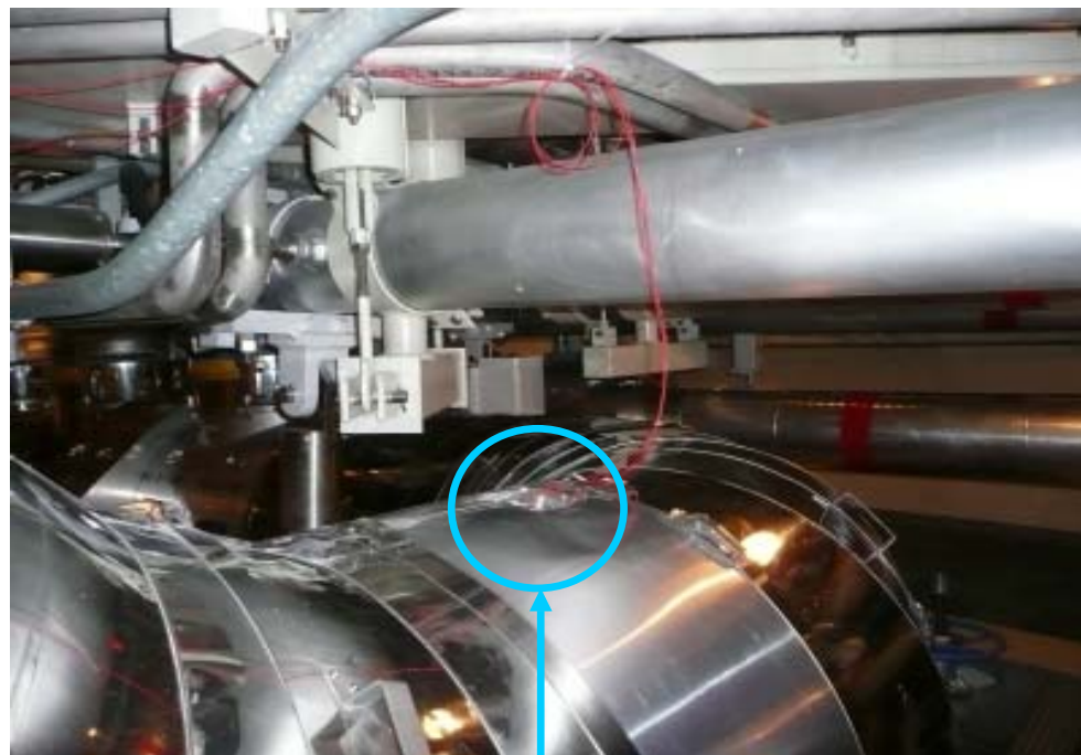
格納容器内の重要な配管に 振動計を取付、振動確認を実施
