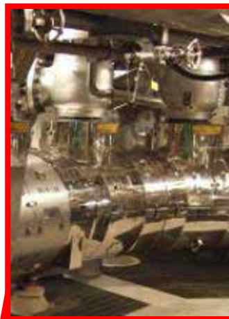
主蒸気逃し 安全弁(18台)
