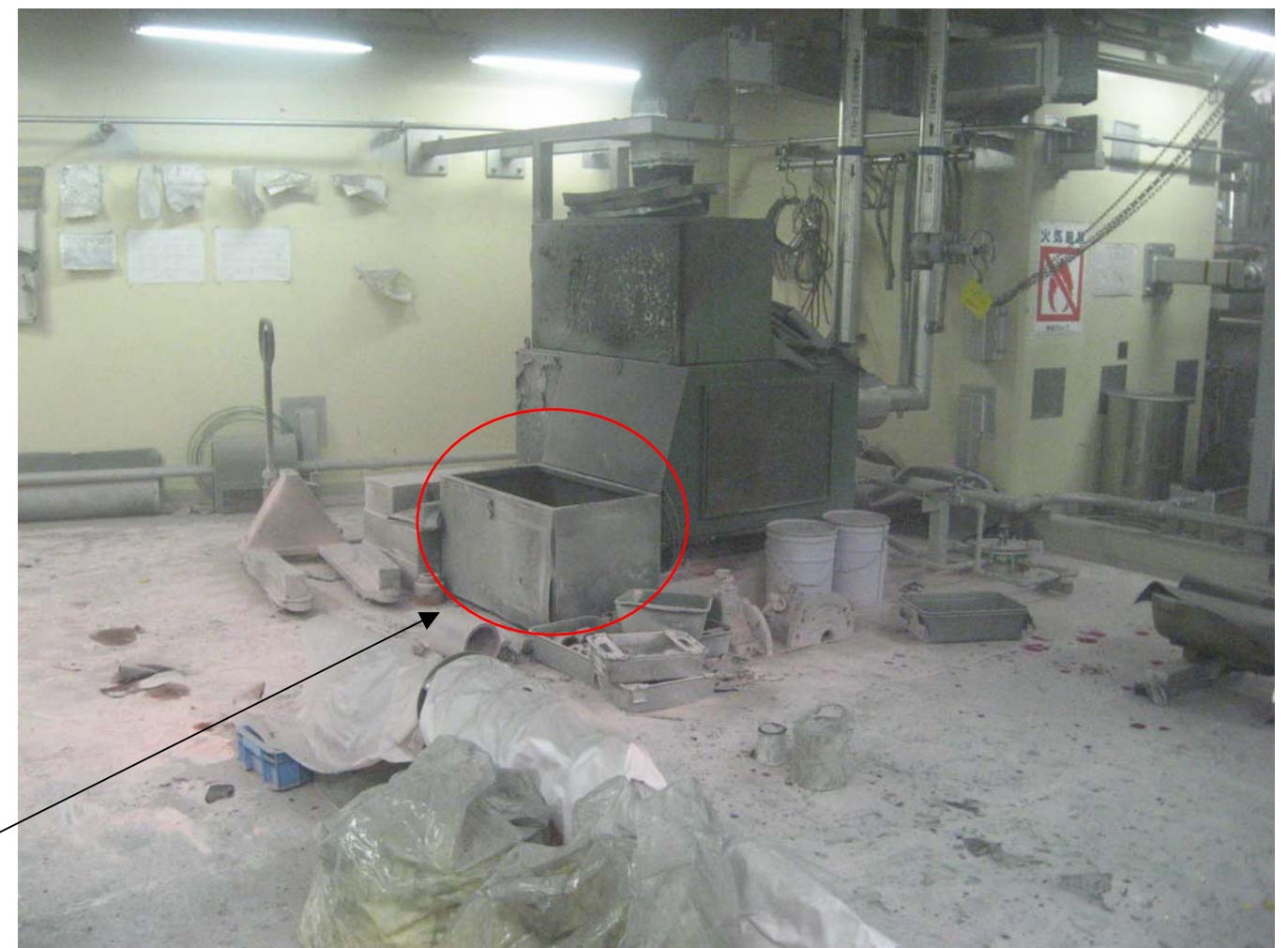
火災現場状況
