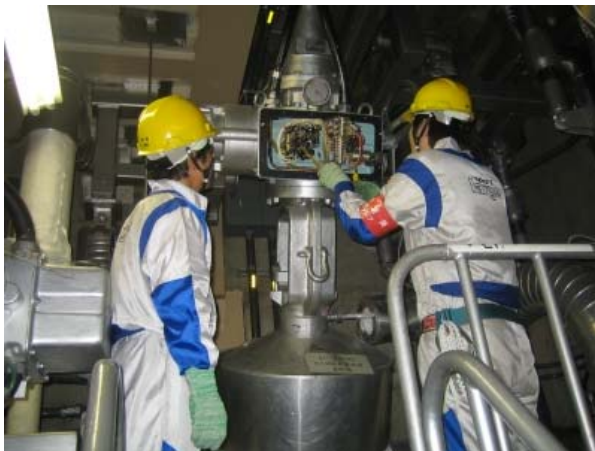
1号機 残留熱除去系弁の点検
