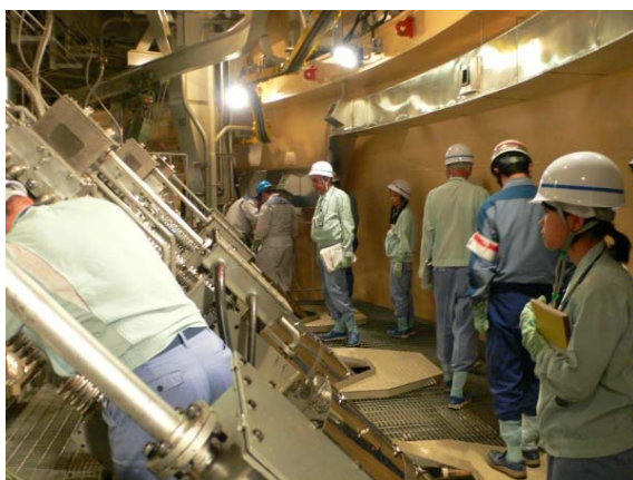
4号機 主蒸気隔離弁
