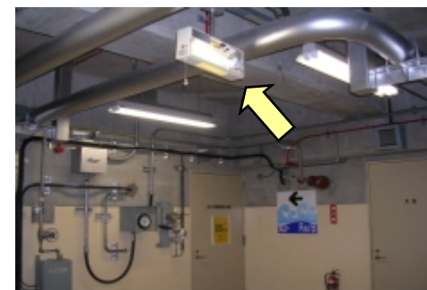
非常灯の破損(7号機) 復旧済み
