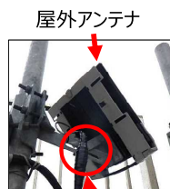
屋外アンテナ コネクタ接続部
