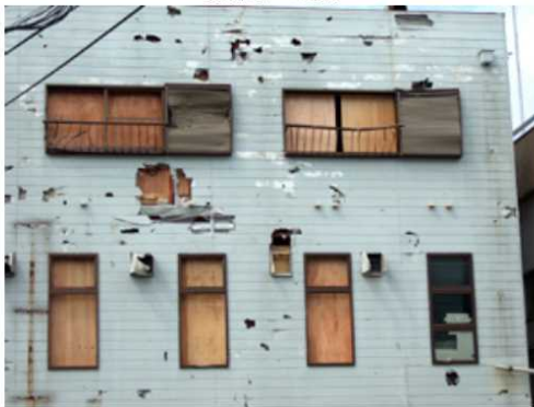
飛散物による家屋への被害（平成18年9月17日：宮崎県延岡市） 写真提供：気象庁
