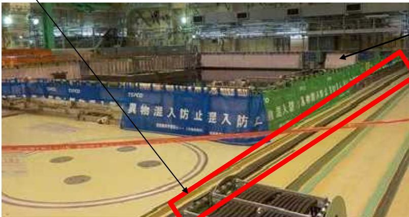
6号機 オペレーティングフロア（管理区域）
