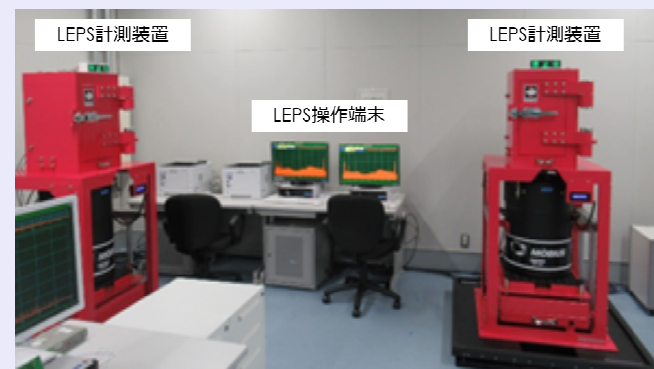
＜低エネルギー光子用ゲルマニウム半導体検出器(LEPS)の設置状況＞
