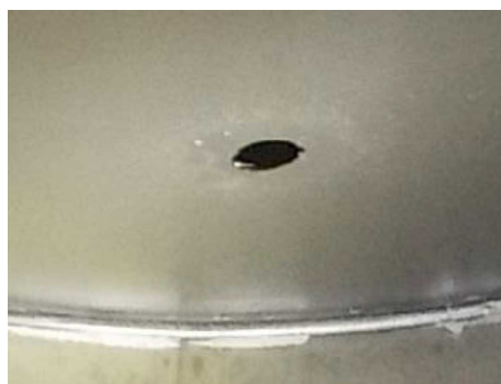
配管外側（欠損有）
