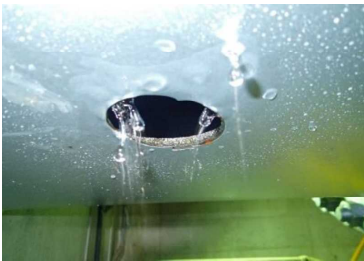
<★欠損箇所（配管外部より撮影：10/20）>
