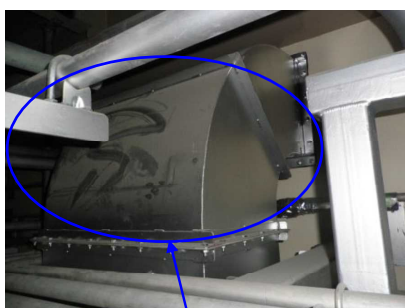
a. 7号機原子炉建屋 空調ダクト
