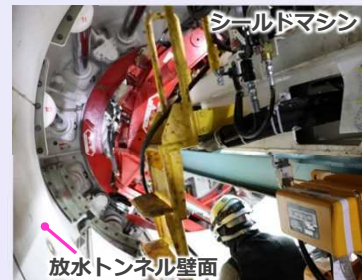
シールドマシン内部で後方から前方部を撮影 <シールドマシン掘進作業の状況>
