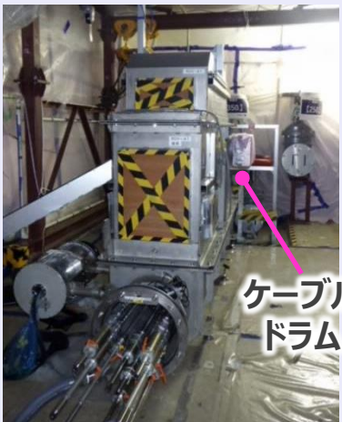
<装置の設置状況>
