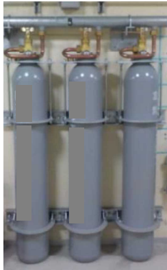
消火薬剤貯蔵容器 (ハロゲン化物ボンベ)
