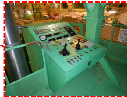
①燃料取替機操作盤
