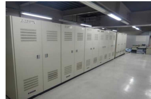
②燃料取替機制御盤 ※オペレーティングフロアに隣接する制御室に設置
