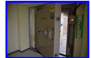
水密扉等の溢水対策 (屋内複数箇所)
