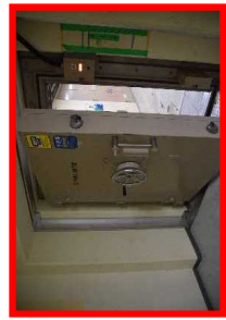
水密扉等の溢水対策 (屋内複数箇所)
