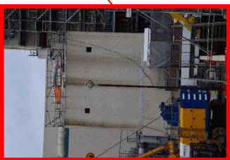
フィルタバント設備 (地上式)
