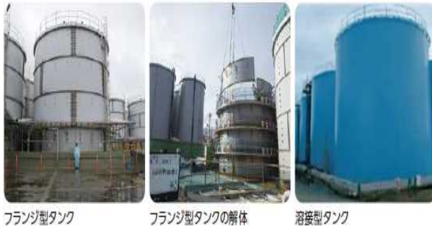
フランジ型タンク
