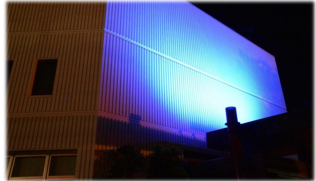
車寄せの屋根の上に投光器を設置し壁面をライトアップ
