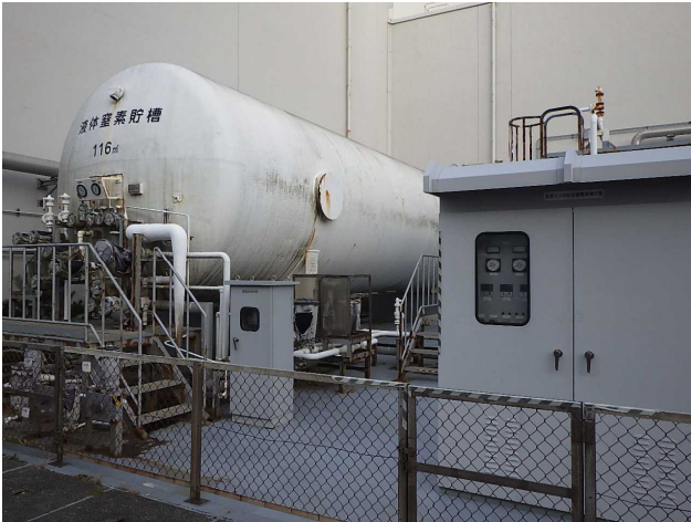
＜格納容器内ガス濃度制御系＞
