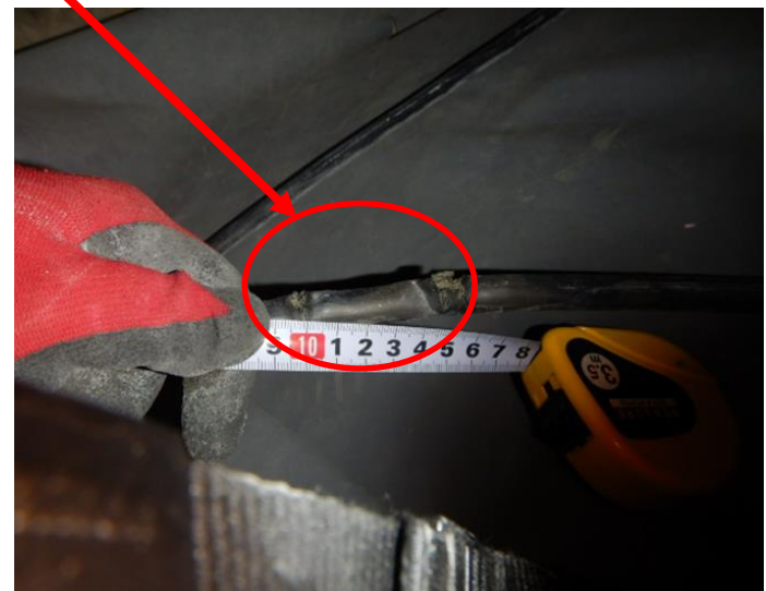
ケーブル損傷の状況
