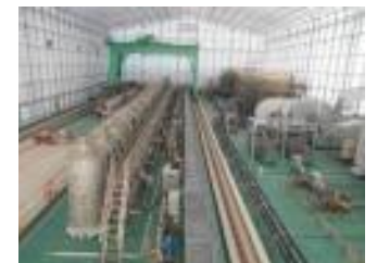
(高性能多核種除去設備)
