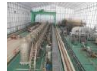
(高性能多核種除去設備)
