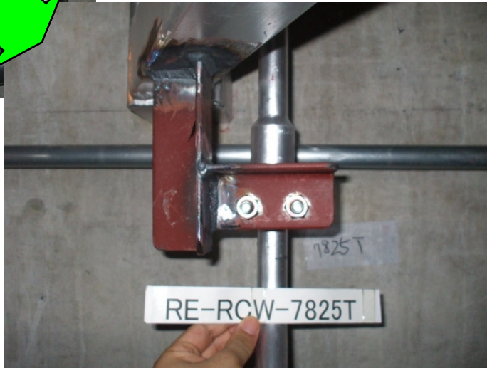
サポート追加により、配管の揺れを低減
