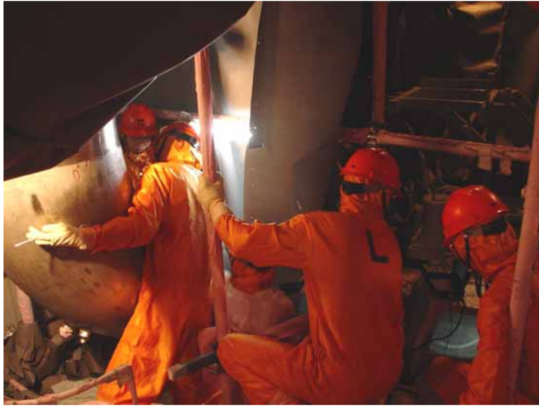
CCDカメラとビデオを使った配管内部の最終確認の状況(2号機)
