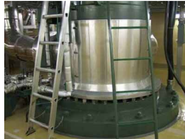
残留熱除去系 ポンプ
