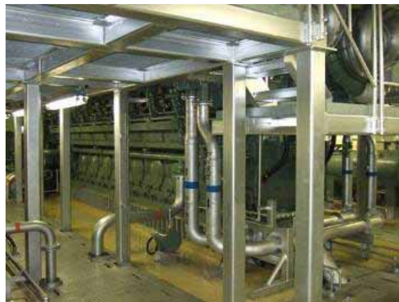
非常用ディーゼル発電機下部
