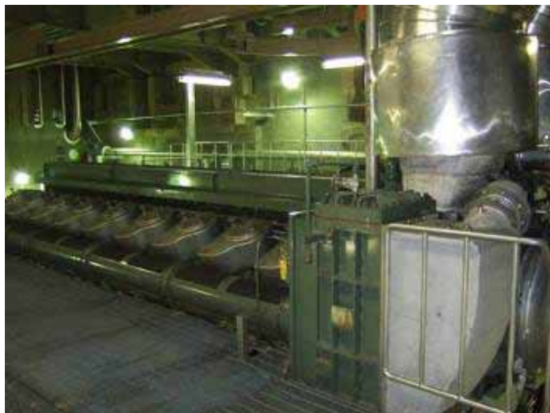
非常用ディーゼル発電機上部
