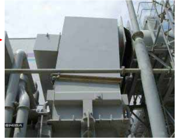
主変圧器 一次側接合部ズレ
