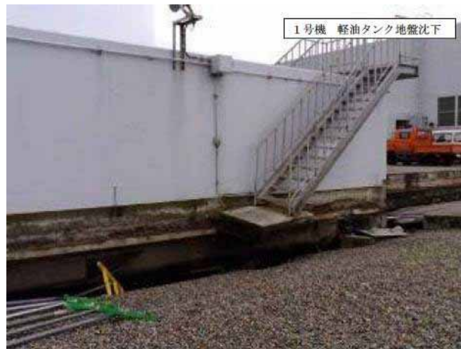
軽油タンク周辺地盤の沈下
