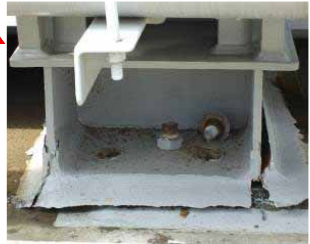
主変圧器基礎ボルト損傷
