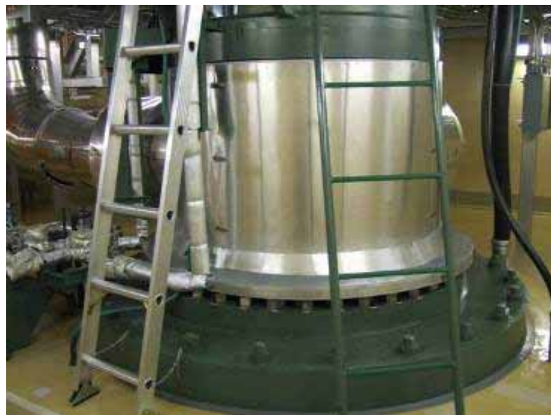
原子炉建屋地下5階 （残留熱除去系ポンプ）
