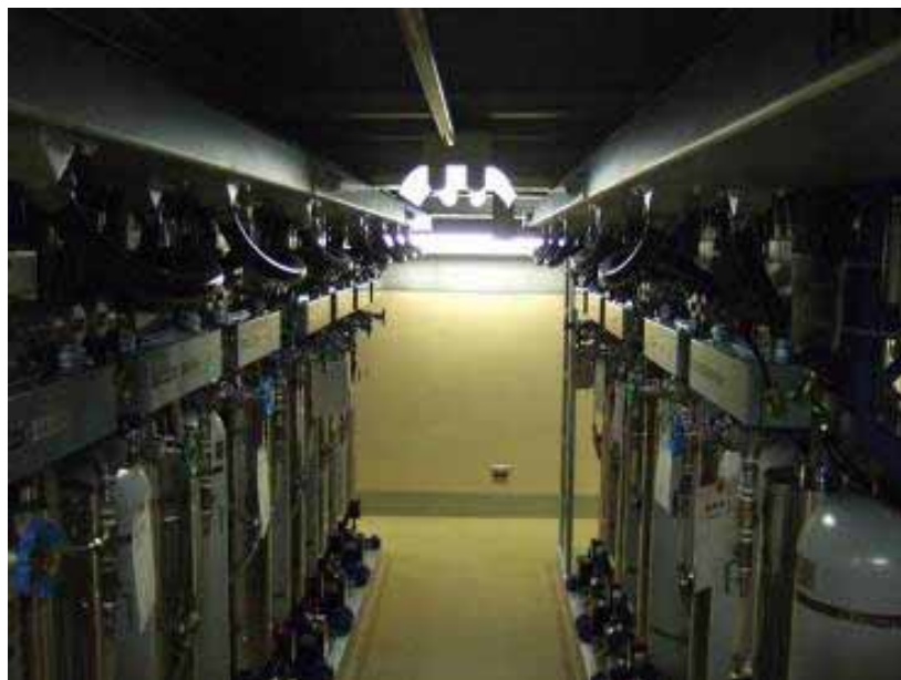
原子炉建屋地下1階 （水圧制御ユニット）
