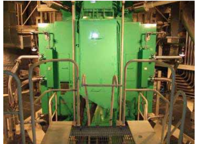
原子炉建屋地下3階 格納容器内 （原子炉冷却材再循環系ポンプ）
