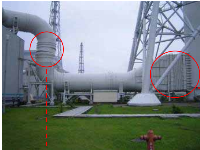
1号機 排気ダクト外観
