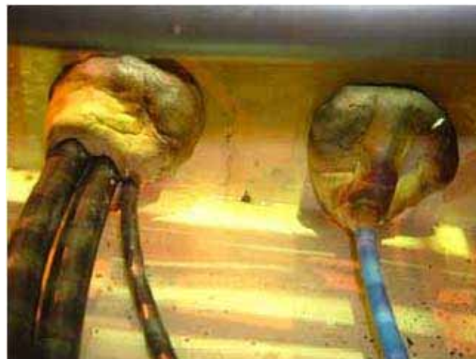
燃料交換機ケーブル（床下）
