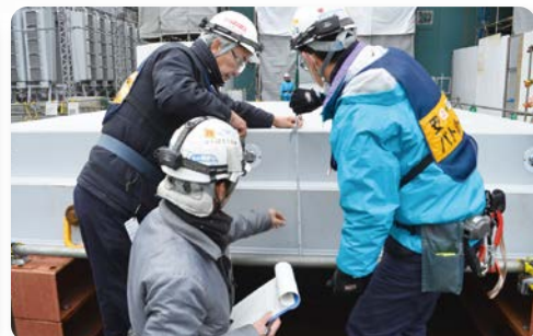
非常用の電源設備を竜巻から守る 扉の寸法を測定
