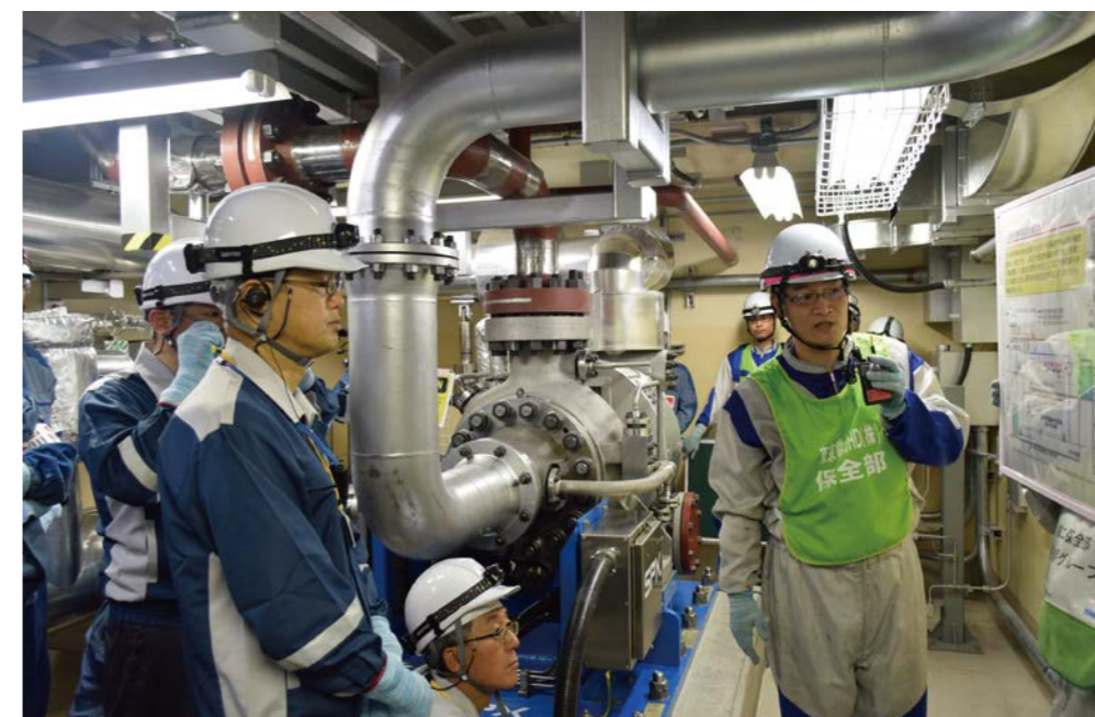
非常時に使用する冷却用のポンプについて説明をする当社社員(右)
