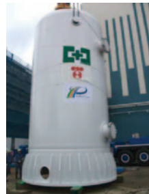
フィルタバント設備
