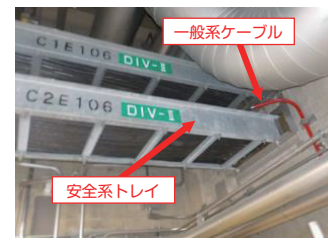
7号機 現場ケーブルトレイ 一般系ケーブルが安全系トレイに入り込んでいる
