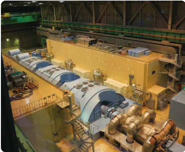
タービン設備
