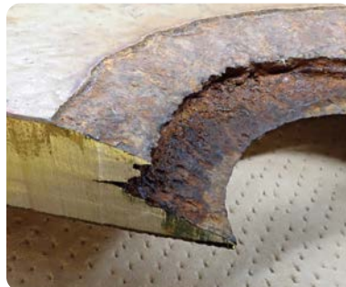
〈配管切断面から見た欠損部〉
