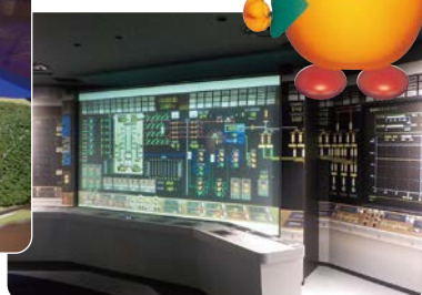
6、7号機の中央制御室を模した大型モニター
