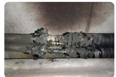
熱で溶けたケーブルの接続部
