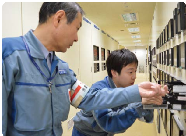
記録計の動作状況を確認
