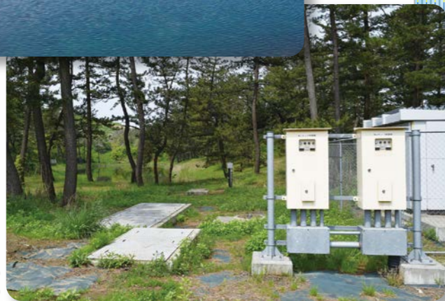
井戸(中央のマンホール)ポンプの制御盤(右手前)
