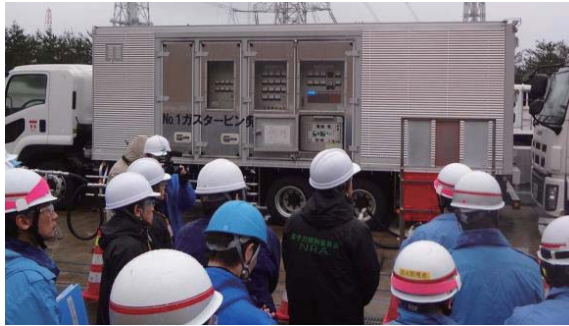
ガスタービン発電機車
