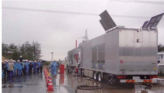
ガスタービン発電機車の起動訓練
