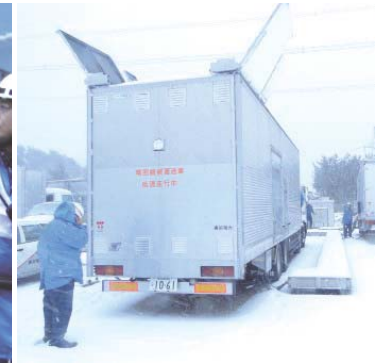
ガスタービン発電機車の操作訓練
