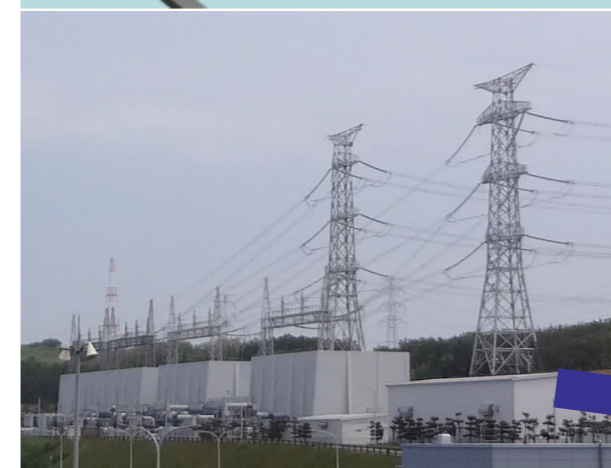
〈開閉所〉 発電所と送電線をつなぐ設備です
